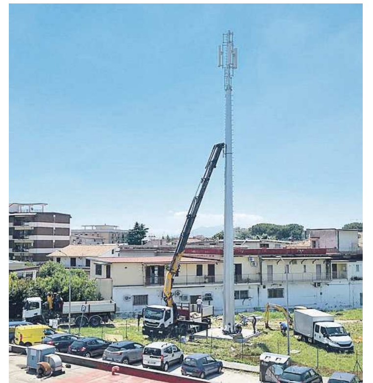
PARCO CERASOLA L'antenna posizionata in pieno centro abitato; scatta la mobilitazione dei residenti con il parroco
